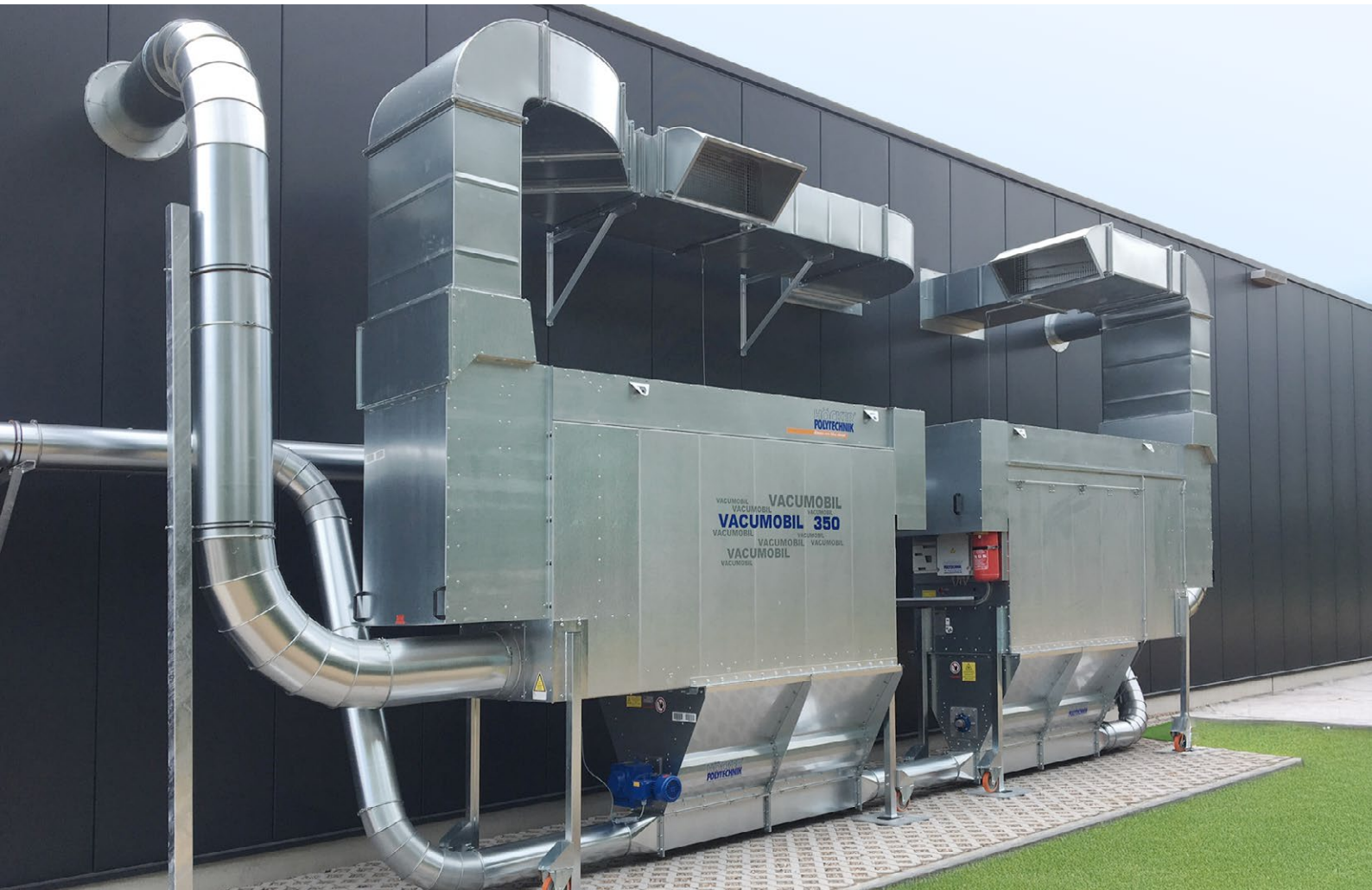
Twee Vacumobile JZ 350 in buitenopstelling. De gefilterde lucht wordt teruggevoerd naar de productie en de warmte-energie blijft behouden.
