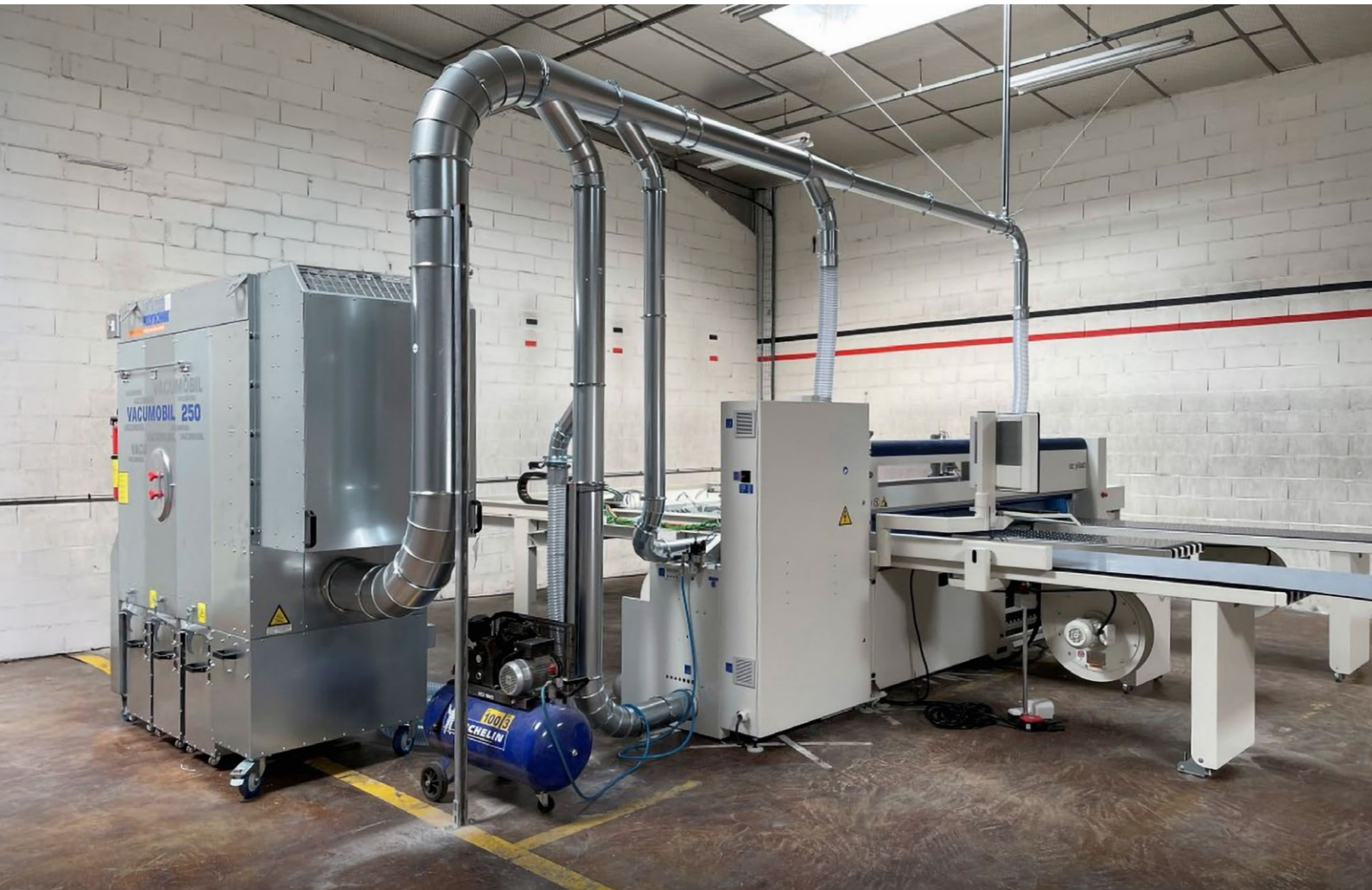
Afzuiging van een opdeelzaag in de kunststofverwerking met de Vacumobil JT 250 en afvoer naar in opvangtonnen.
