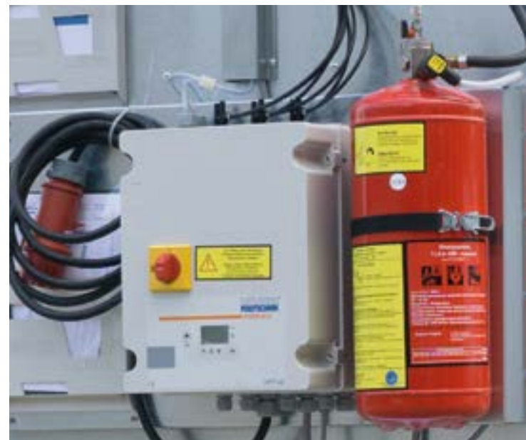
Afb. onder: PLC besturing, Geïntegreerde automatische brand onderdrukking systeem
